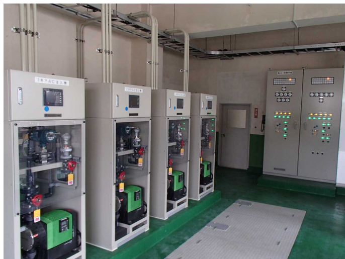
(判田浄水場 薬品注入設備)
