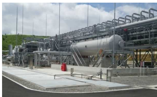
菅原バイナリー発電所
