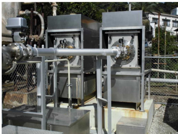
地場企業を中心に開発された 湯けむり発電システム
