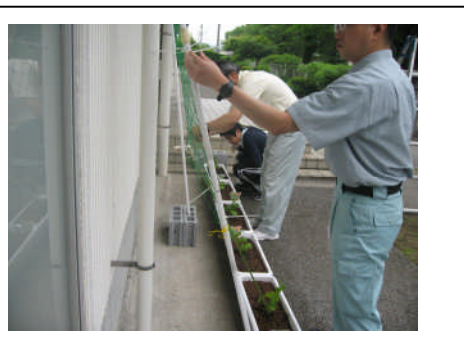
両端は、建物の排水管にポールをくくり、つたの重みで倒れないように補強します。
