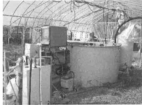
写真2 流調槽へのBK添加装置
