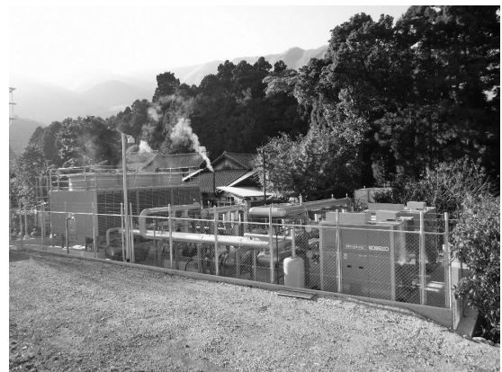
既存の温泉井を活用した発電施設
