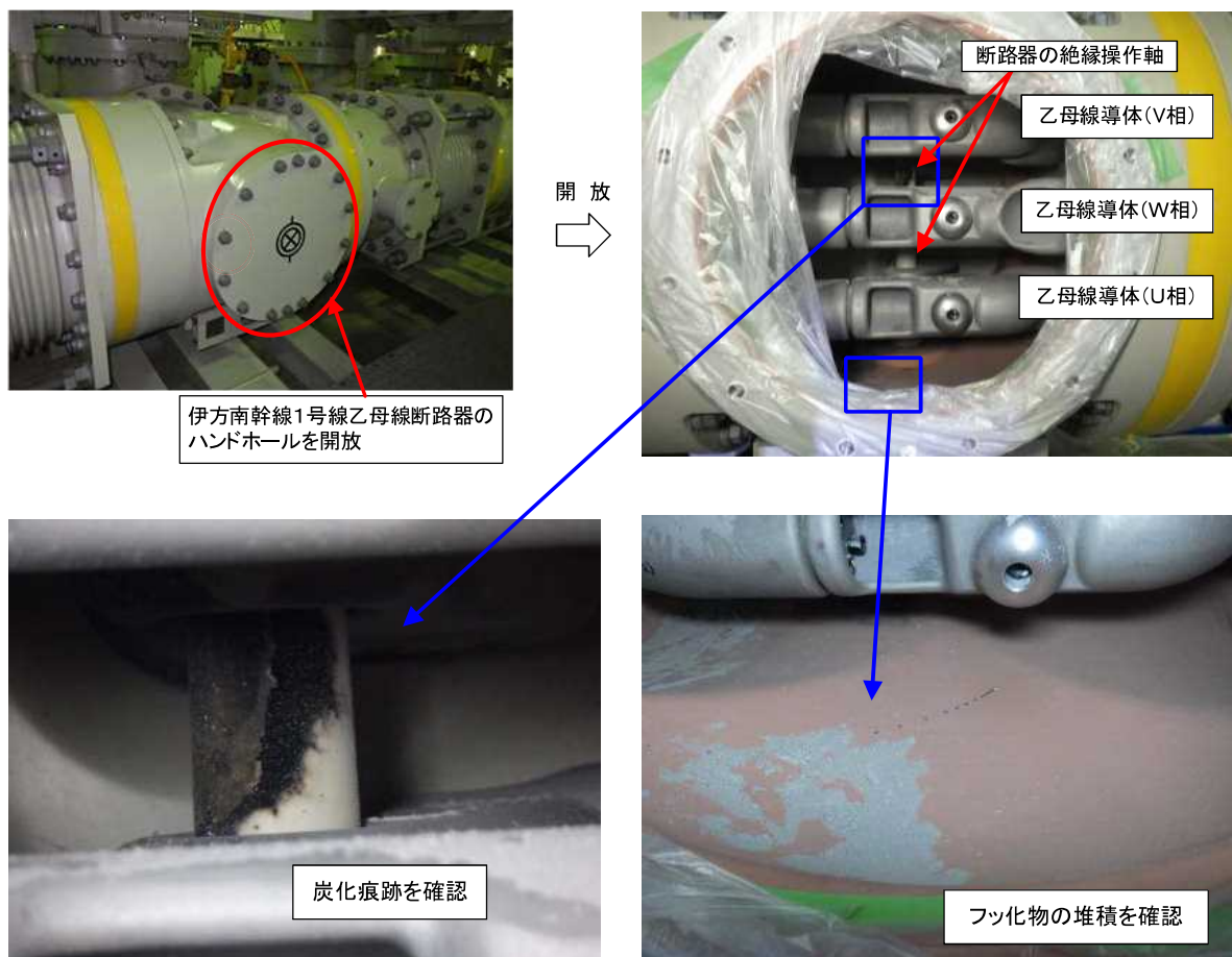
図 1 伊方南幹線 1 号線乙母線断路器ユニットの開放写真
