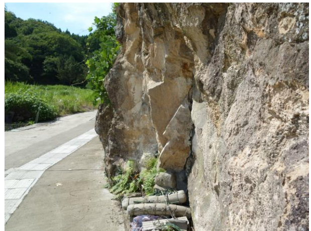
周辺露頭における崖面に沿った亀裂の発達状況
