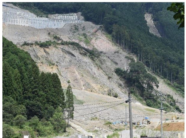
斜面崩壊地の現在（2020年8月） 斜面崩壊防止工事が続けられている
