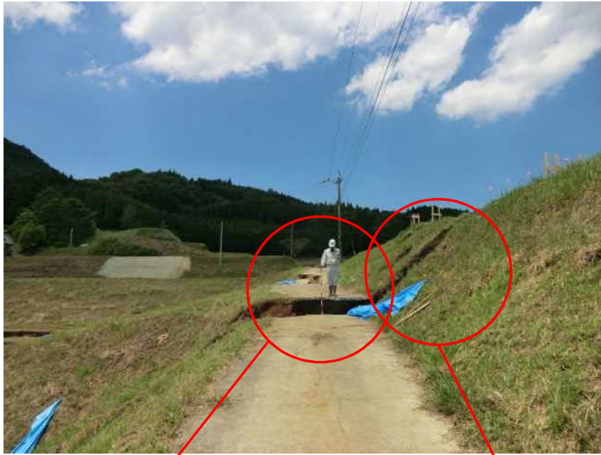
頭部の農道の段差亀裂 および 水田斜面の陥没帯
