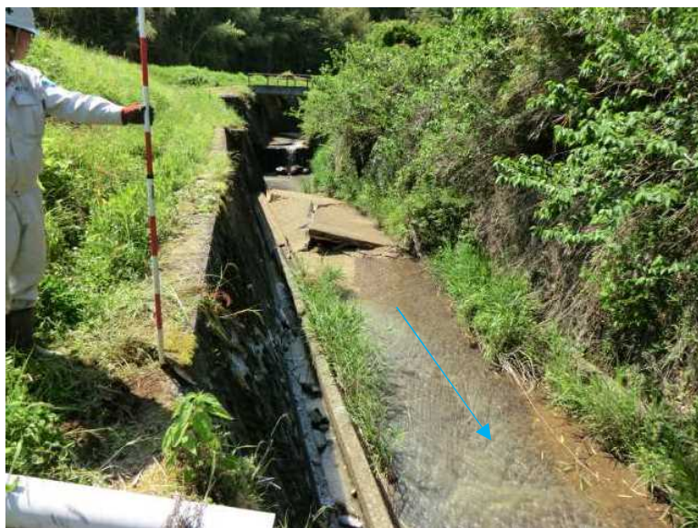
平井川左岸側護岸に押され 座屈した底板コンクリート
