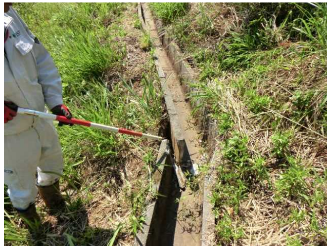
地盤変動によりずれが生じた水路
