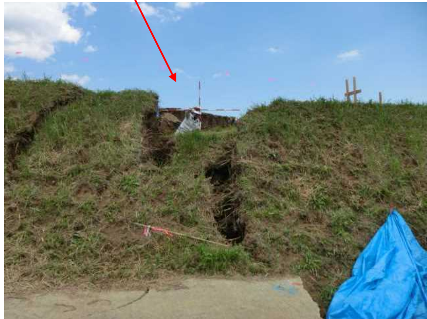
水田斜面の陥没帯 幅約2m
