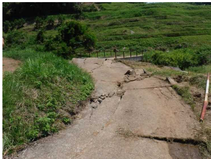
市道橋に押され座屈した右岸側市道
