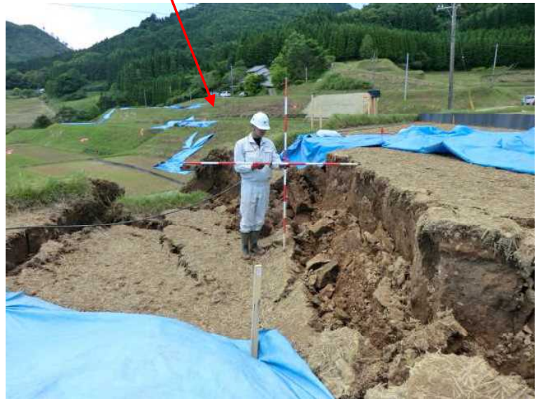
頭部の水田の段差亀裂 段差約1m
