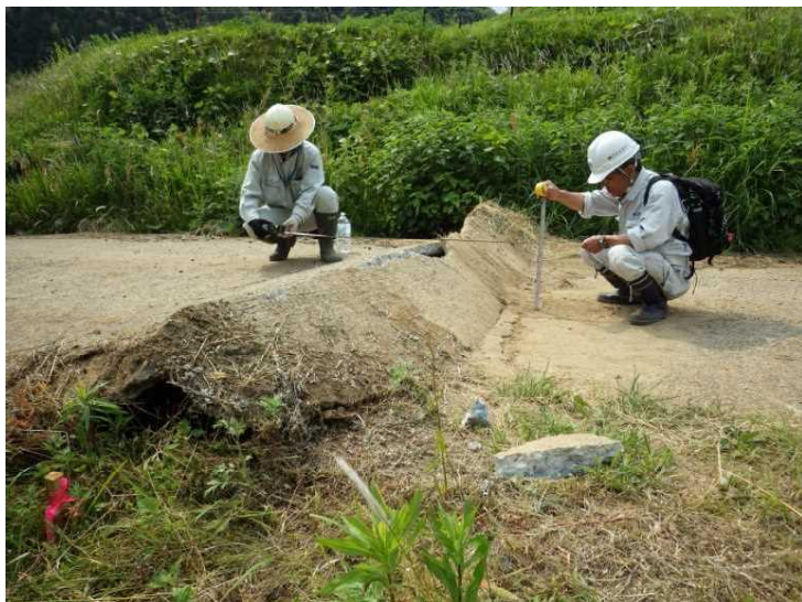
圧縮により座屈した市道
