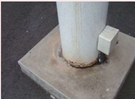
ポールの根元にサビが発生
