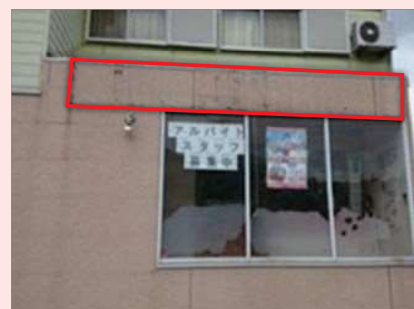
落下した後の壁面
