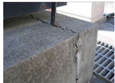
看板基礎のひび割れ
