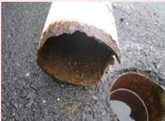
ポールの根腐れによる倒壊
