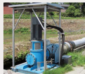
竹田市 城原井路小水力発電所
