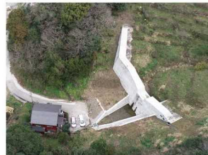
災害関連緊急砂防事業 岩屋川1（津久見市）
