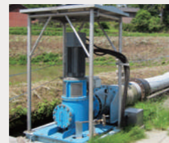
竹田市 城原井路小水力発電所
