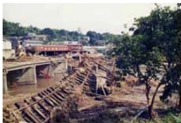
玉来川JR豊肥本線鉄道橋の流失(H2.7洪水)
