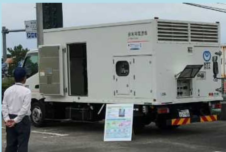
展示(非常用電源車)
