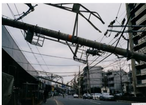
図 3.46 六甲道駅付近における電柱倒壊状況
