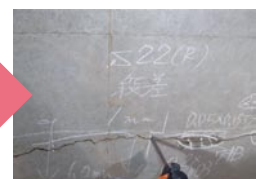
ひび割れの状況
