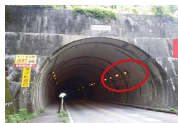
早期対策が必要なトンネル
