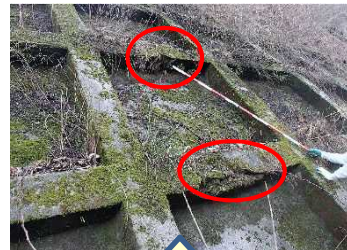
破損・鉄筋の露出
