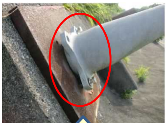
頭部キャップボルト 緩み・欠損
