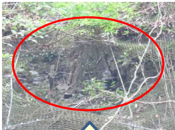
ネットの破損
