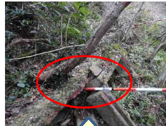
天端部の破損
