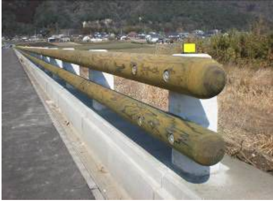
木製ガードレール
