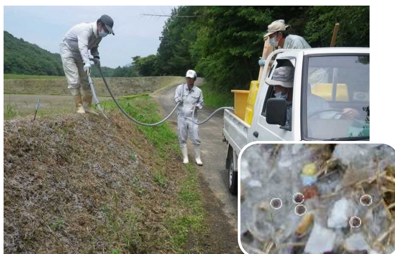
写真Ⅱ32-5 豊後高田市畑地区既設法面での吹付作業 (2014年6月16日)
