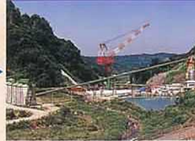
タワークレーン
