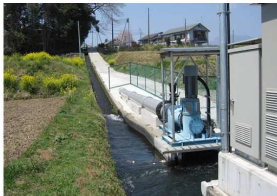
城原井路小水力発電所(竹田市)
