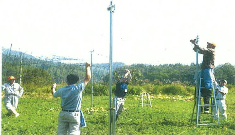
玖珠町での設置状況
